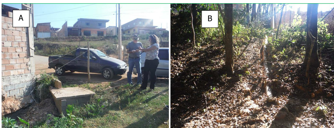
Figura 5.8 – (A) caixa de passagem que recebe esgoto bruto (B) lançamento de esgoto in natura na localidade da Matinha.
