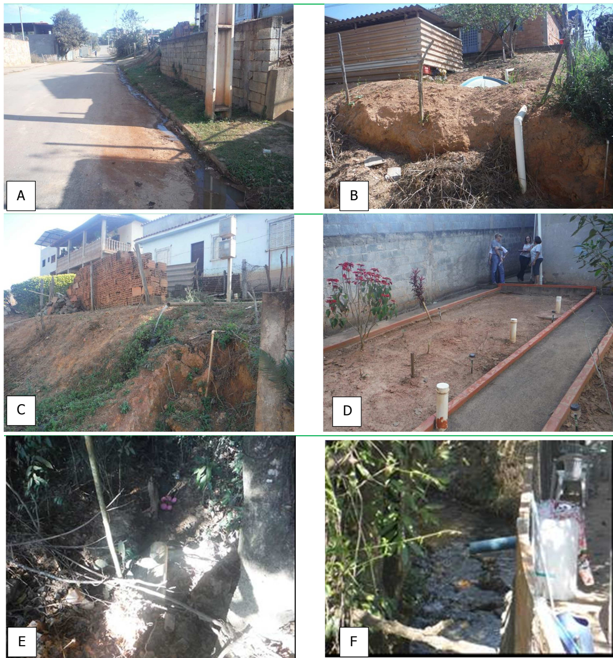
Figura 5.3 – (A), (B), (C) águas cinzas lançadas a céu aberto e (D) sistema de fossa, filtro e sumidouro, (E) e (F) lançamento de esgoto no leito do córrego do Viana.
